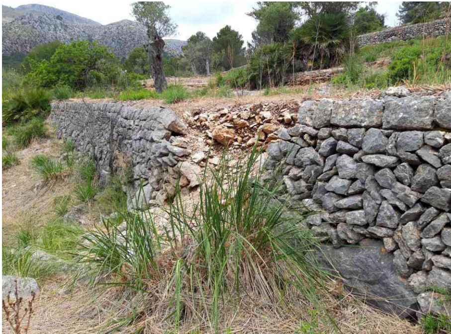
Detall de petit esbucament a na Llaneres
